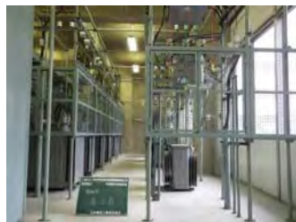
(改修前) 老朽化した変圧器
