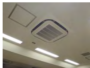
(改修後) 高効率空調用室内機
