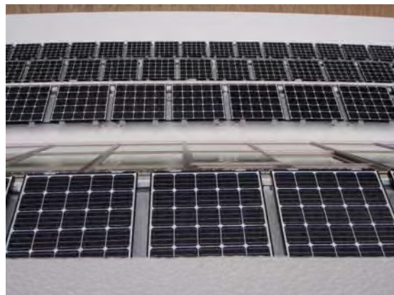
カーボンニュートラル・エネルギー国際研究所 屋上の太陽光発電
