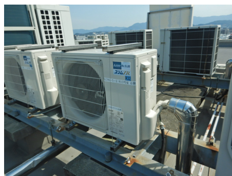
(改修後) 室外機 (高効率)
