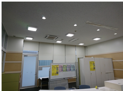
(改修後) LED照明
