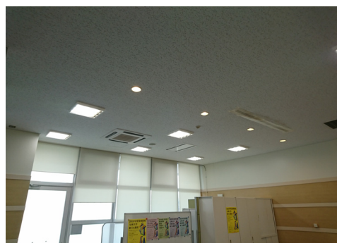
(改修前) 蛍光灯
