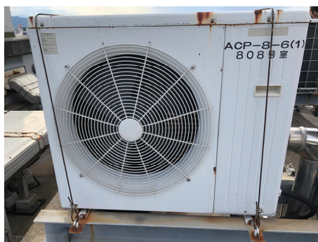
(改修前) 室外機
