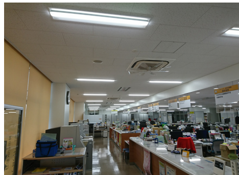
(改修後) LED照明
