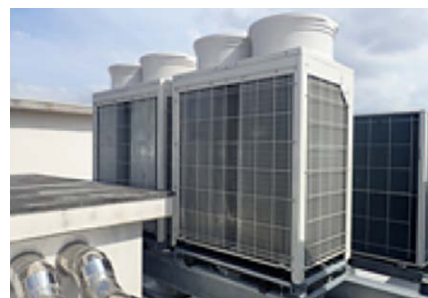
改修後（室外機／高効率）
