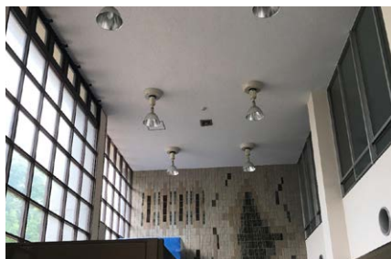
改修前（水銀灯）
