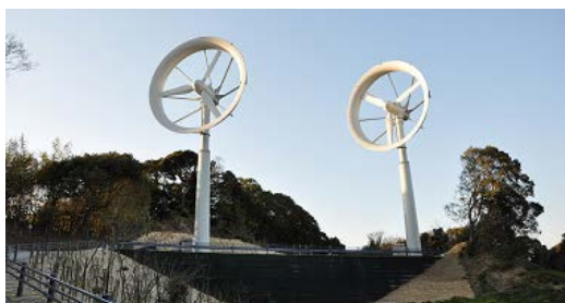
70kW×2 風レンズ型風力発電設備
