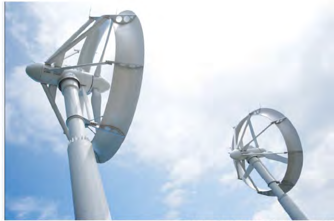
風レンズ風力発電設備(100kW機) キャンパス北西部保全緑地部分
