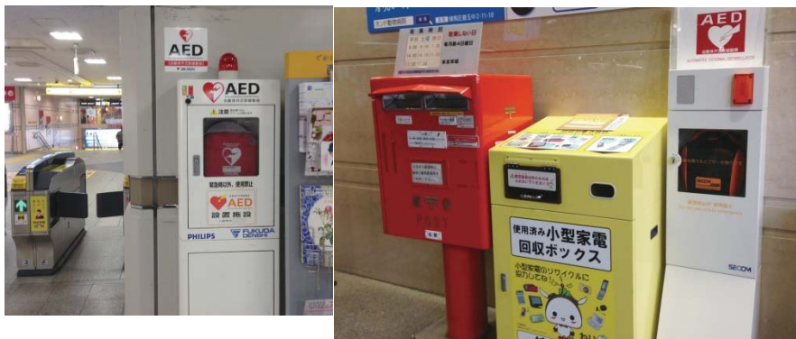
図13.7 AEDの設置状況事例（厚生労働省、2015）
