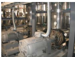
(改修前) 空調用冷水 2 次ポンプ
