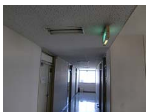
(改修前) 20W×2 蛍光灯
