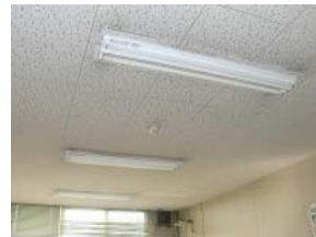
(改修後) HF 蛍光灯 32W
