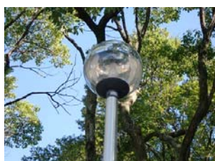
(改修前) 水銀灯 300W
