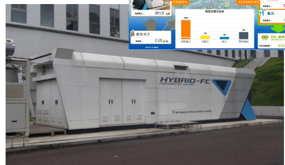
300kW 燃料電池発電設備
