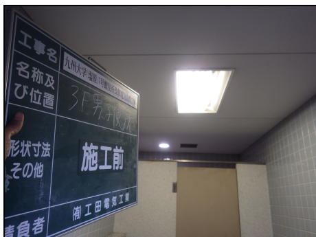
(改修前) 蛍光灯
