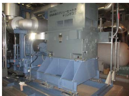
(改修後) 圧縮機ユニット(高効率型)
