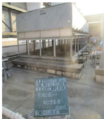
(改修前) 空気熱交換器
