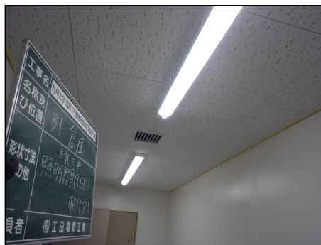
(改修後) LED照明
