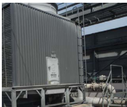
(改修前) 冷却塔
