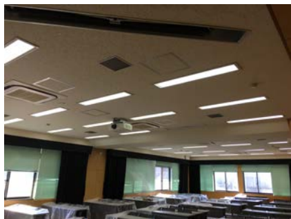
(改修前) 蛍光灯
