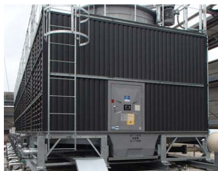
(改修後) 冷却塔 (高効率型)
