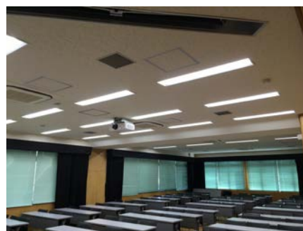
(改修後) LED照明
