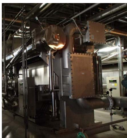
(改修前) 吸収式冷凍機
