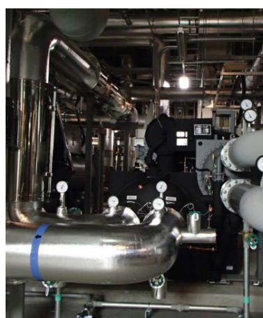
(改修後) ターボ冷凍機 (高効率型)
