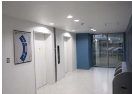
(改修後) LED照明
