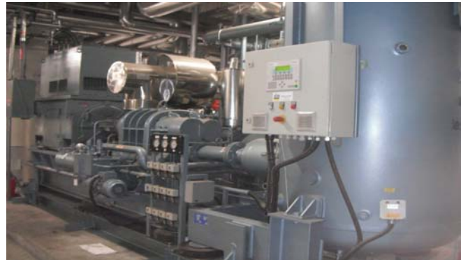
冷凍機設備 スクリューチラー
