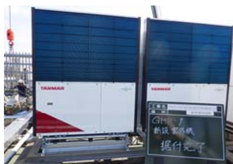
(改修後) 室外機 (高効率)
