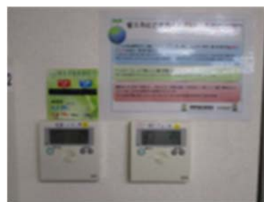
空調リモコン付近
