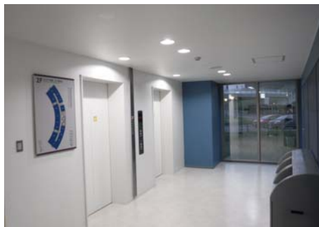
(改修後) LED照明
