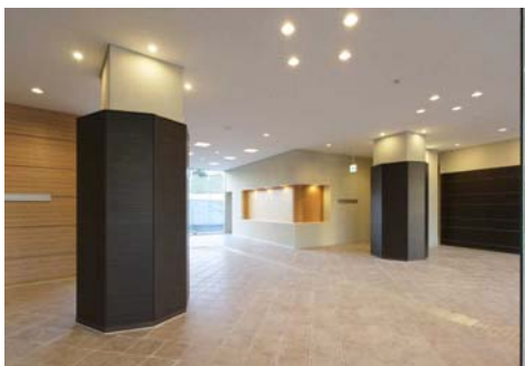
(改修前) 蛍光灯
