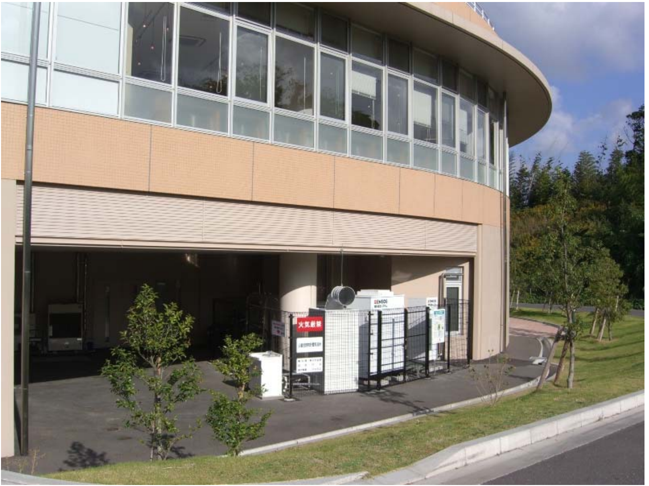
「ビッグどら」に設置された燃料電池システム
