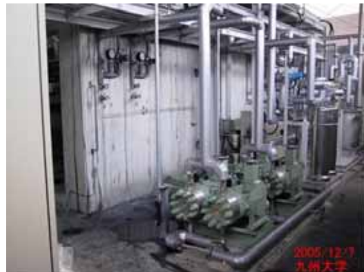
写真9 西側周辺機器室に飛散した黒色水
