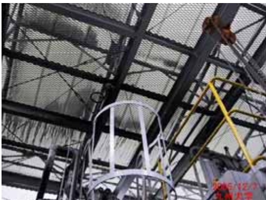
写真11 HHEG 室の天井と梁に飛散した黒色水
