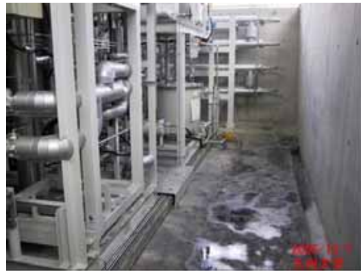
写真7 HHEG 室内南側通路に飛散した黒色の噴出水
