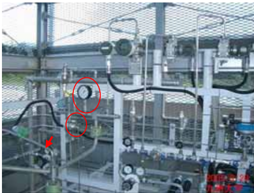
写真1 酸素分離タンク酸素放出ラインの事故前の状況： は圧力計と自動弁、矢印は配管をさす
