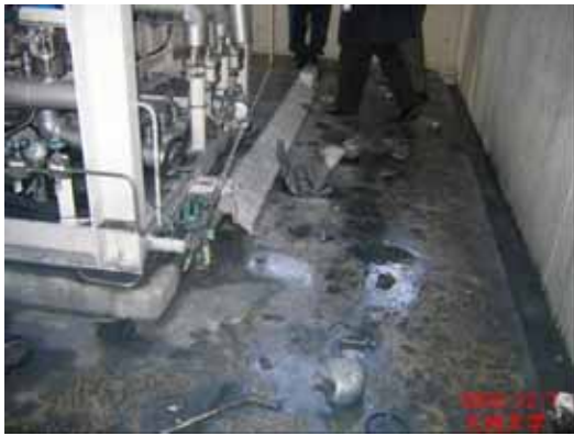
写真6 HHEG 室内西側通路に飛散した落下物と黒色の噴出水
