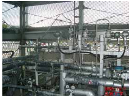
写真2 酸素分離タンク酸素放出ラインの事故前の状況：図1で示した圧力計と自動弁、矢印で示した配管がなくなっている。他にも配管の破断や欠損がみられる
