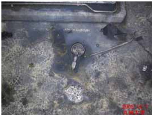
写真10 HHEG 室内に飛散した破損物：圧力計（中央）と配管（右上）
