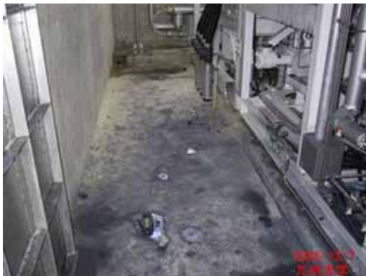
写真8 HHEG 室内北側通路に飛散した落下物と噴出水
