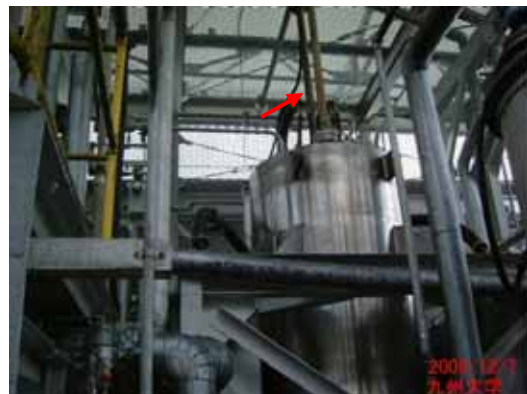
写真12 HHEG 室の南側からみた電解セルタンク：タンクは外見上損傷していないが上方にのびる水配管が変色
