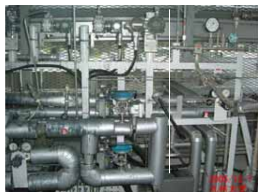
写真4 酸素放出ライン（白線より左）と水素放出ライン：被害は酸素放出ラインで顕著であることがわかる
