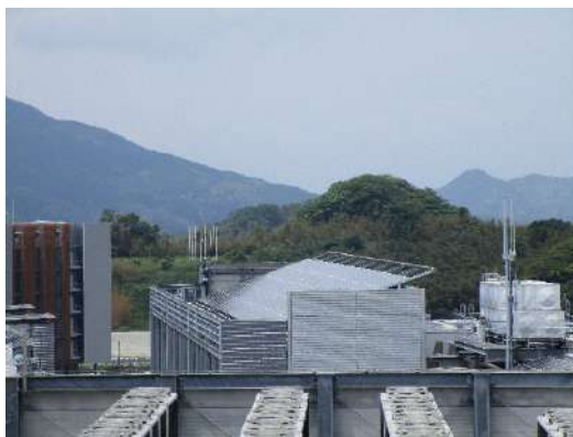
建物屋上の太陽光パネル
