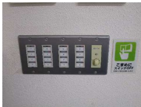
事務室照明スイッチ付近に掲示
