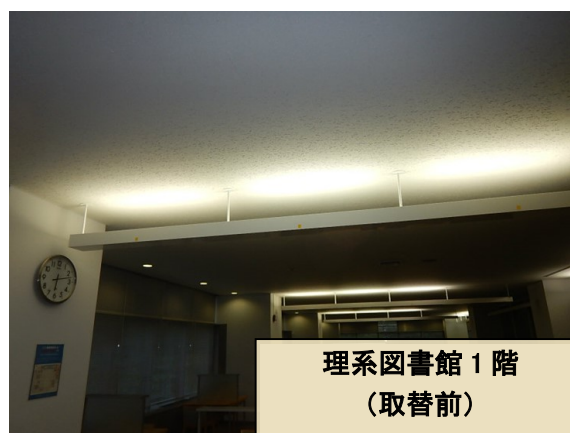
理系図書館の照明(令和2年3月に一部をLEDに取替)
