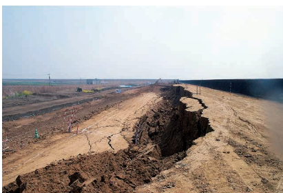
農業土木構造物の崩壊
