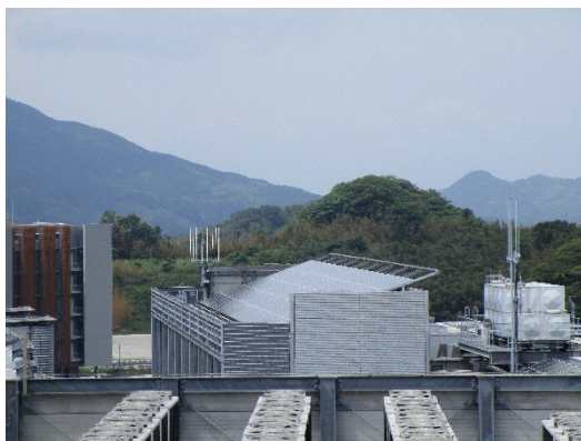
建物屋上の太陽光パネル
