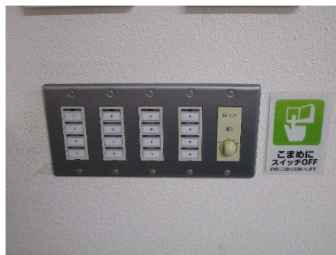
事務室照明スイッチ付近に掲示
