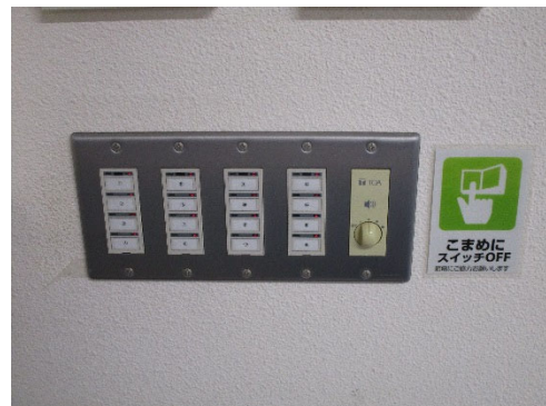
事務室照明スイッチ付近に掲示
