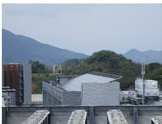
建物屋上の太陽光パネル
