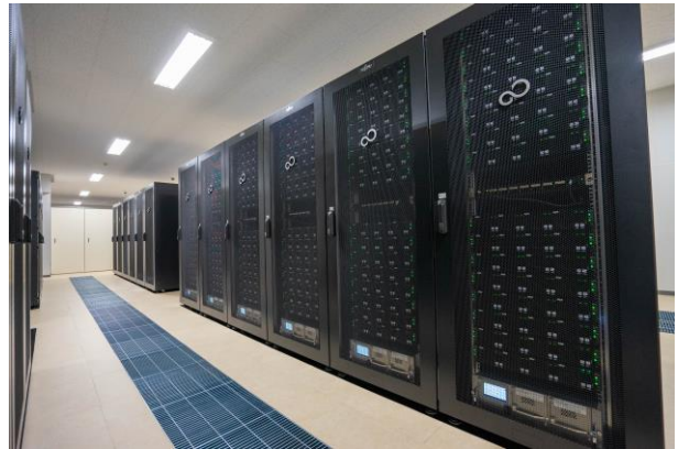
伊都キャンパス内に導入された玄界システム
