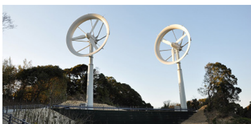
70kW×2 風レンズ型風力発電設備
