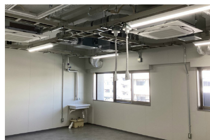
改修後（室外機／高効率）
