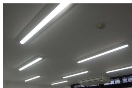
改修後（LED照明）
