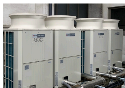
改修後（室外機／高効率）
