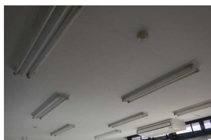
改修前（蛍光灯）
