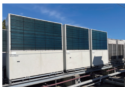
改修前（室外機）
