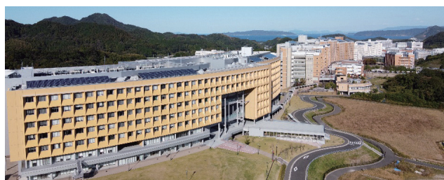
（伊都）ウエスト5号館屋上の太陽光発電設備
