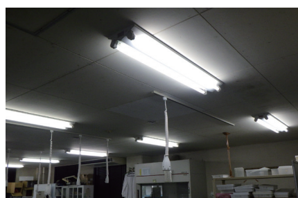
改修前（蛍光灯）
