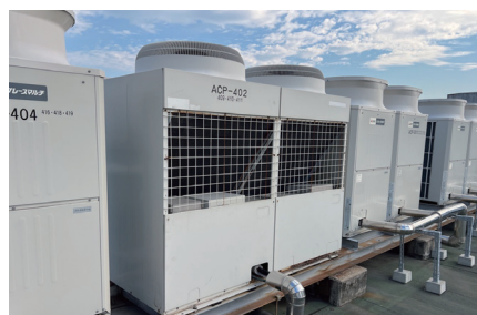
改修前（室外機）
