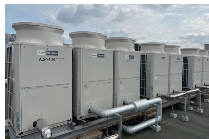
改修後（室外機／高効率）
