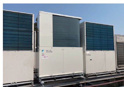
改修後（室外機／高効率）
