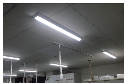
改修後（LED照明）
