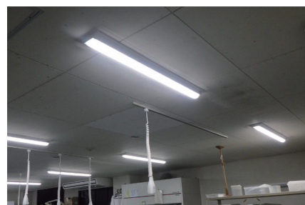
改修後（LED照明）
