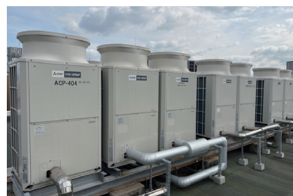
改修後（室外機／高効率）
