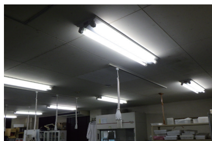
改修前（蛍光灯）
