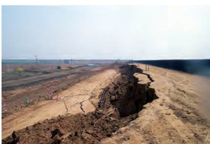
農業土木構造物の崩壊
